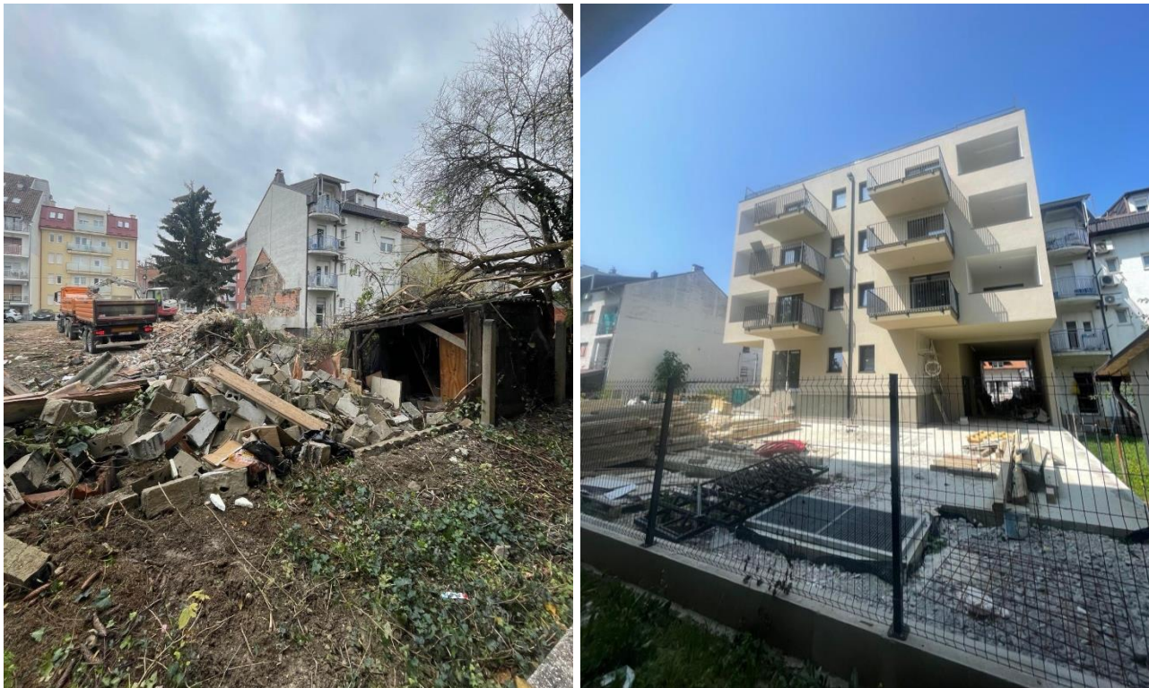
Slika 7. (lijevo) Rušenje kućice u Sokolgradskoj (Autorska fotografija, 30. studenoga 2023.) i Slika 8. (desno) Stambena zgrada (Autorska fotografija, 12. lipnja 2025.)
